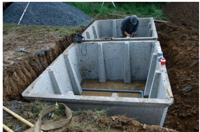
Cuves en béton constituant l'enveloppe étanche de la lagune
